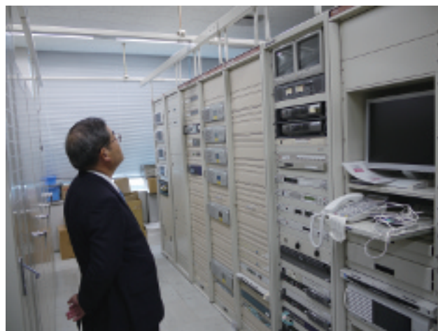
県庁内衛星通信設備設置状況
