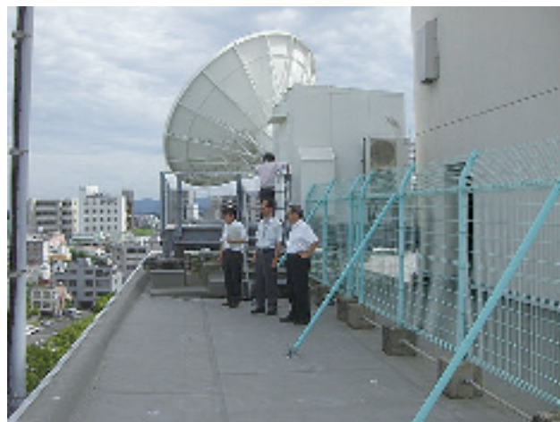
宮崎県庁衛星通信設備の視察
