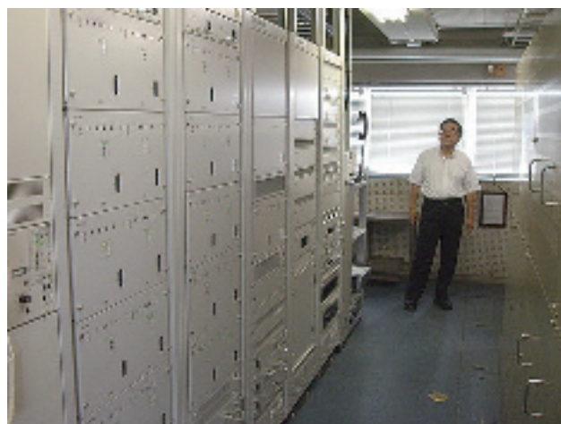
宮崎県庁衛星通信設備の視察
