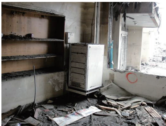
津波により浸水した衛星通信設備
