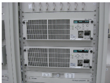
山口管制局（センター局）SSPA（固体化電力増幅器）
