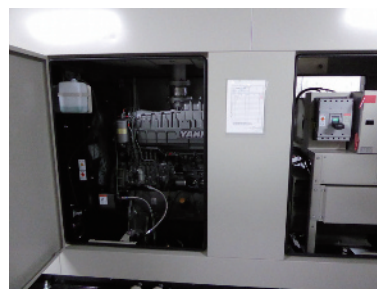
山口管制局（センター局）非常用発電設備
